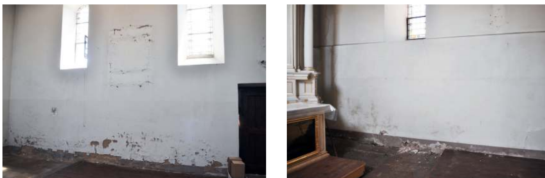
Enduits plâtre dégradés par les remontées capillaires
